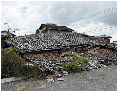
全壊した住宅
